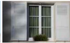
Fouillure autour d'une baie
