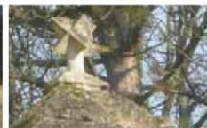
Pinnacle en pierre au dessus d'un puits
